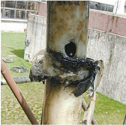
图 2 褐色斑纹为电缆绝缘层在水分和电场同时作用下而产生的水树现象。
