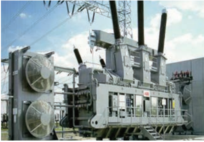
图1 高压输电中使用的变压器。
